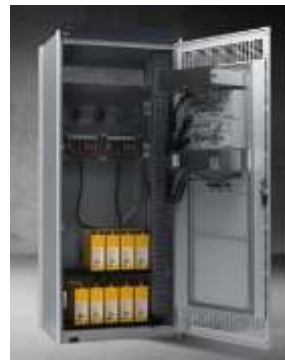
PC10- interiör med batterier.
