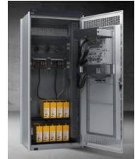
PC10- interiör med batterier.
